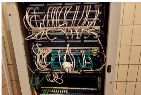
Ukázka přepracovaného rozvaděče
